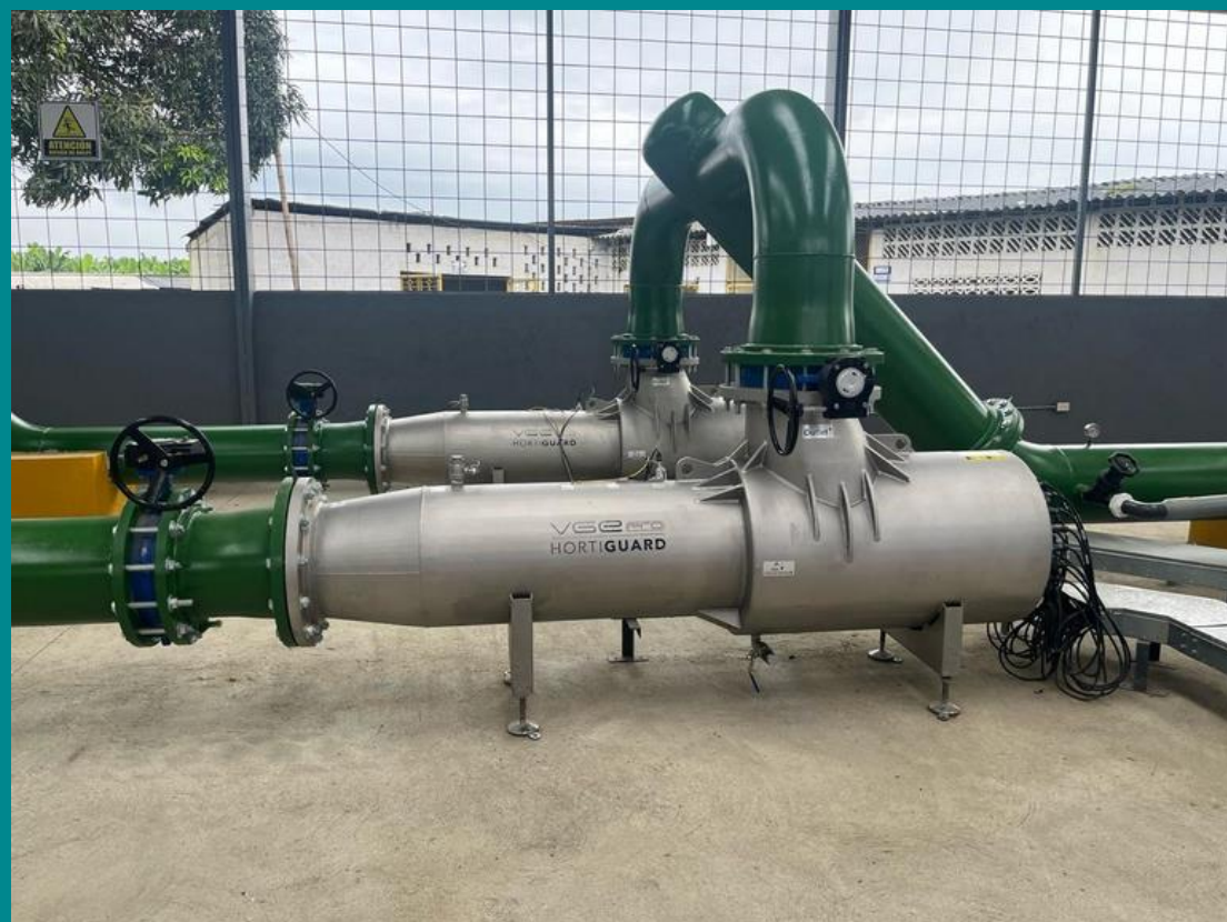
Sistema de desinfección de agua
